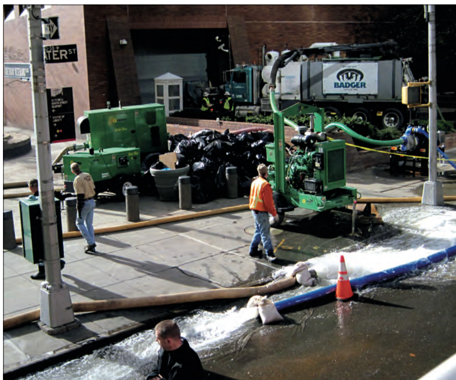
Det pumpes vann fra tunnelbaner og kjellere.
