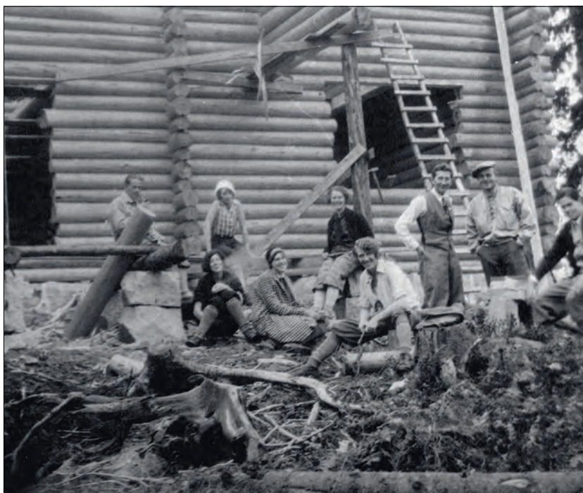
Tannlegehytta under bygging høsten 1929. Mange tannlegestudenter i full sving som ivrige hjelpere for bygningsfolkene.
